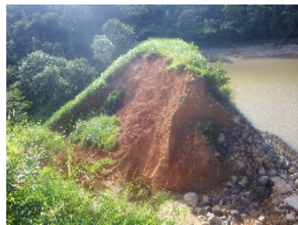
豪雨により決壊したため池（岡山県）
